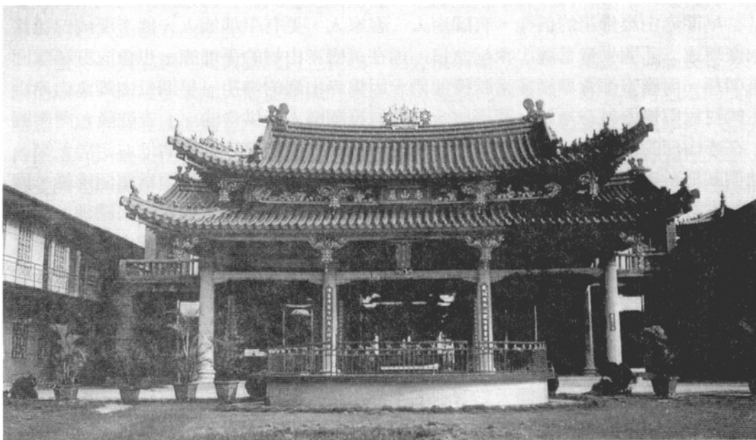
八十四年重修的赤山巖，琉璃瓦顏色變色了外形風貌也失去原味，變成「綠山巖」，與赤山巖原意背道而馳，令人惋惜。
