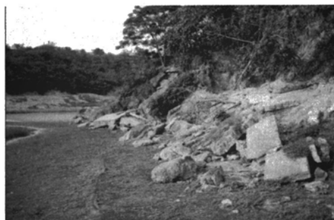
照片一：殘破但巨大的水泥塊散置
